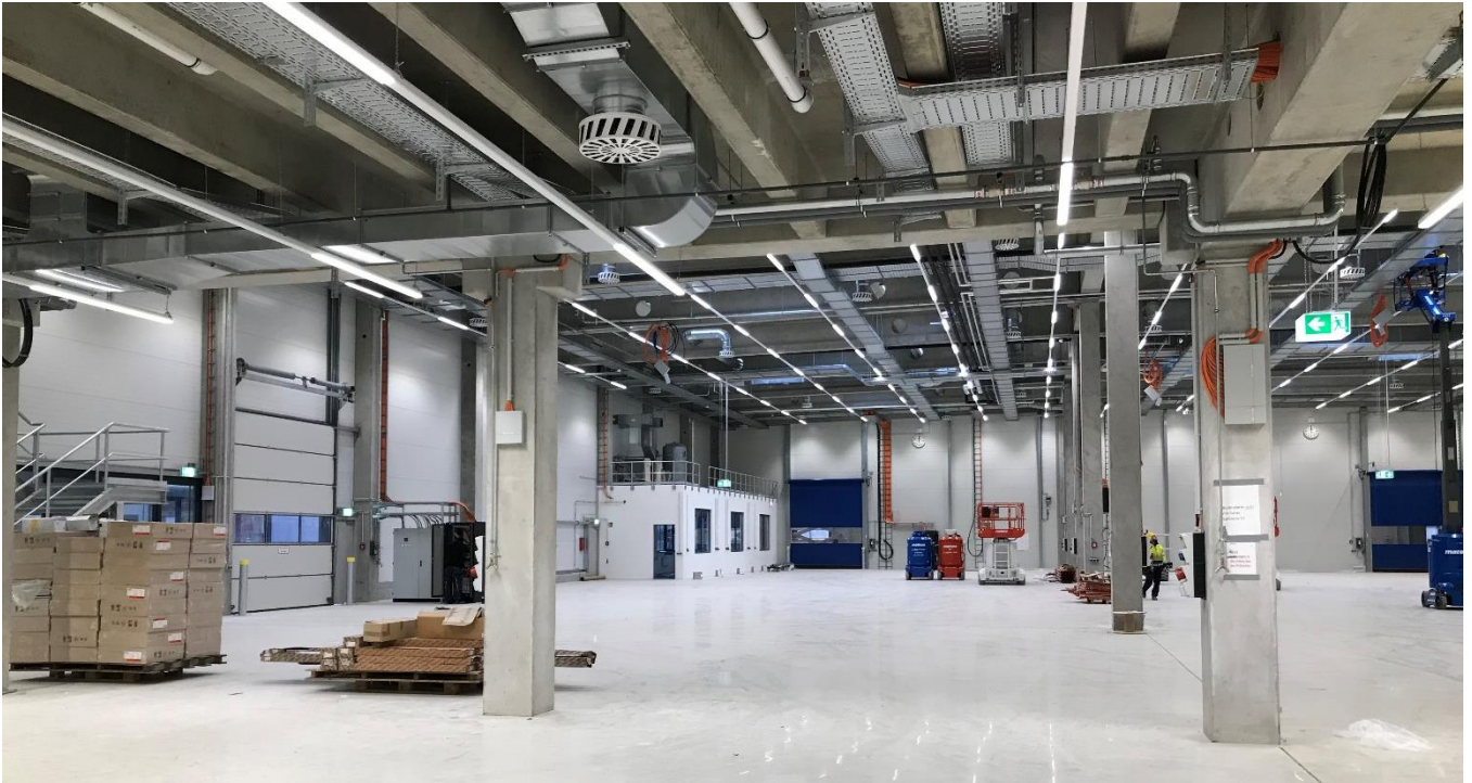
Das neue Batteriemontagezentrum der BMZ Group in Karlstein am Main.
